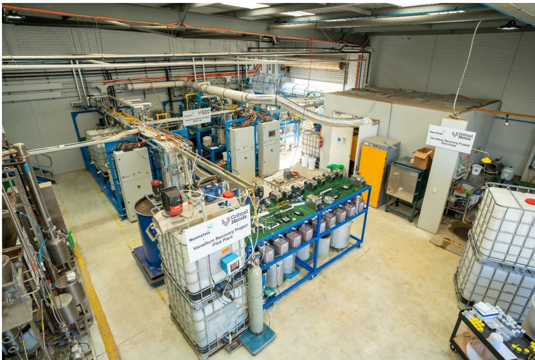
Abbildung 1 - Überblick über die Pilotanlage
